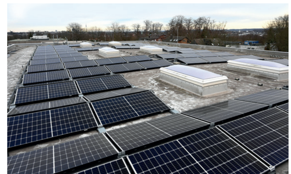
Oben: Das Blockheizkraftwerk auf dem Campus erreicht einen Wirkungsgrad von 90 Prozent und ist somit besonders ressourcensparend. Unten: Die Photovoltaik-Anlagen auf Dächern von TU-Gebäuden erzeugen jährlich rund 54.500 Kilowattstunden Strom und ersparen der Umwelt 20.500 Kilogramm CO 2 . Zukünftig sollen neu zu errichtende Gebäude mit Photovoltaikpanelen ausgerüstet werden, kündigte TU-Kanzler Albrecht Ehlers an.
