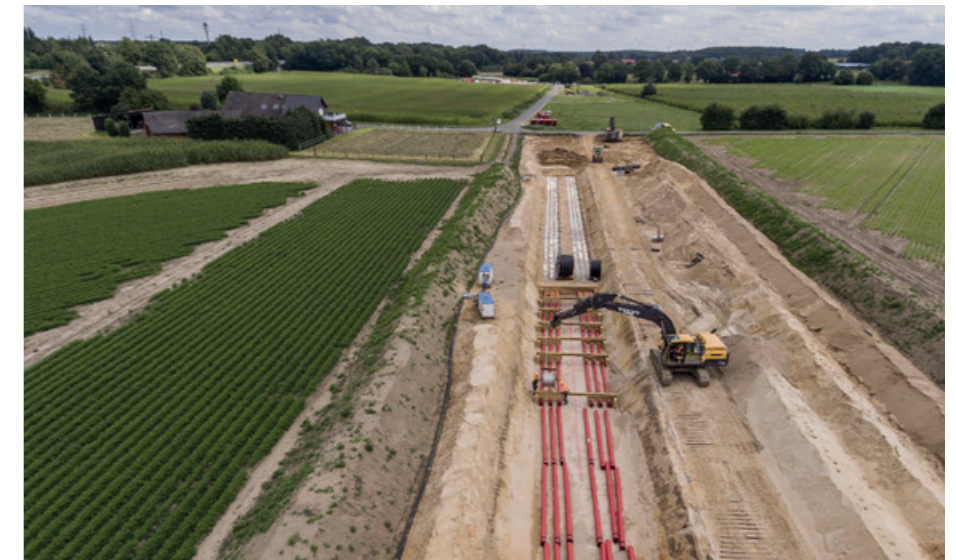
Dieser Strom muss vom Norden in den Süden transportiert werden – dafür werden riesige Stromtrassen gebaut, wie diese Erdtrasse bei Borken in Nordrhein-Westfalen.
